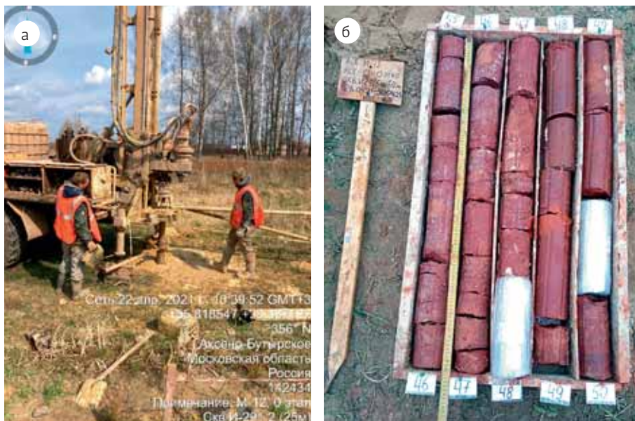
Рис. 9. М-12 Москва – Казань, 0 этап, Московская область, апрель 2021 года. Фотофиксация: а) процесса буровых работ; б) выкладки керна в ящики образцов
